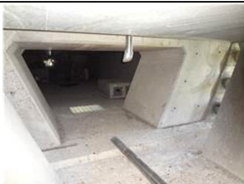
배수시설 (S6-1) 배수관 탈락
