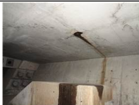
배수시설 (S6-1) 배수관 미설치
