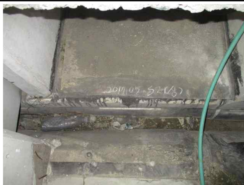
상부 신축이음 (S2-1) 이물질퇴적 (L=1.5)
